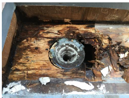
雨漏れによる腐食
